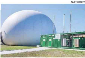
Planta Edar de Bens (A Coruña), que produce biometano a partir de aguas residuales
